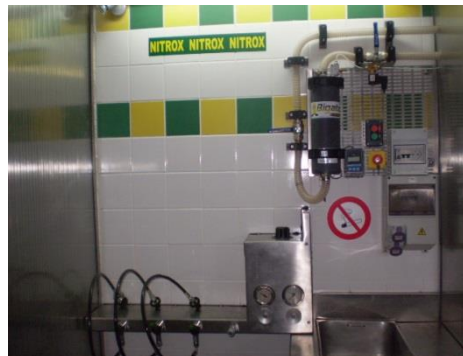
Station de gonflage Nitrox
