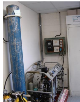
Station de gonflage de la piscine d'Erstein
